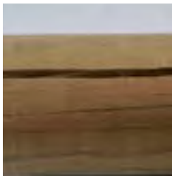
Cracks/Grietas/Fente/Risse/ Crepe/ Barsten/Fendas
